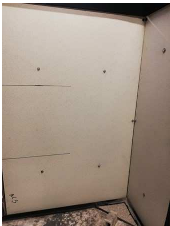
Figura 1 – Montagem dos provetes.
